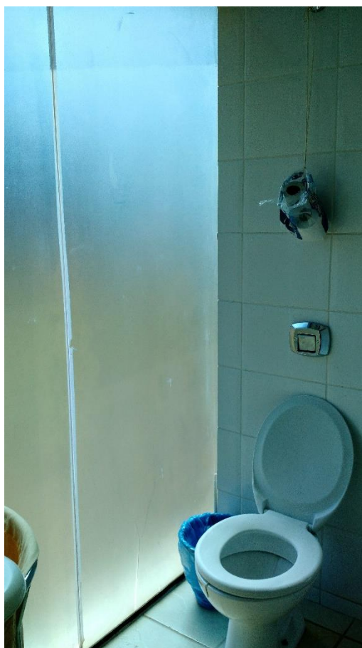
IMAGEM 6 – MUNICÍPIO DE SANTA CECÍLIA DO PAVÃO – BANHEIRO COM PAREDE DE VIDRO, SEMELHANTE AO DE UBS EXISTENTE NO MUNICÍPIO DE PONTA GROSSA
