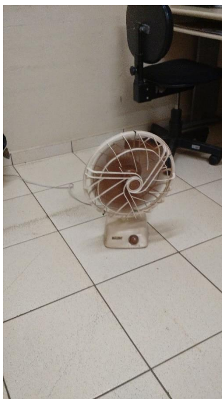
IMAGEM 4 – MUNICÍPIO DE LONDRINA – CLIMATIZAÇÃO DE AMBIENTE NA UBS JARDIM DO SOL
